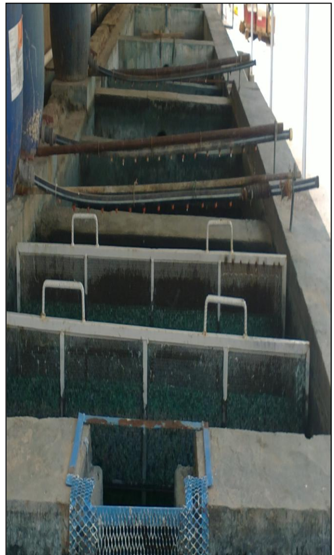
Fig 3: la station d'épuration d'épuration de TISCOBA Guerrara, Ghardaïa
