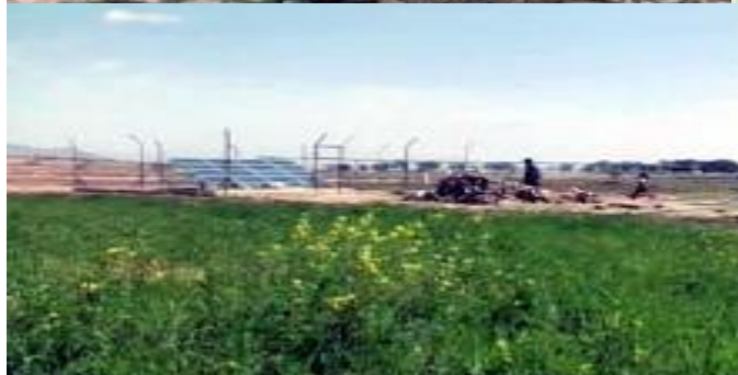
Figure 01 : Utilisation du système d'énergie solaire pour l'irrigation Ras El Oued - Willaya Bourdj Bou Arredj.
